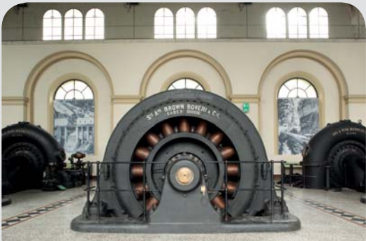
Montereale Valcellina, Malnisio | Ex Centrale idroelettrica "A. Pitter", sala turbine
